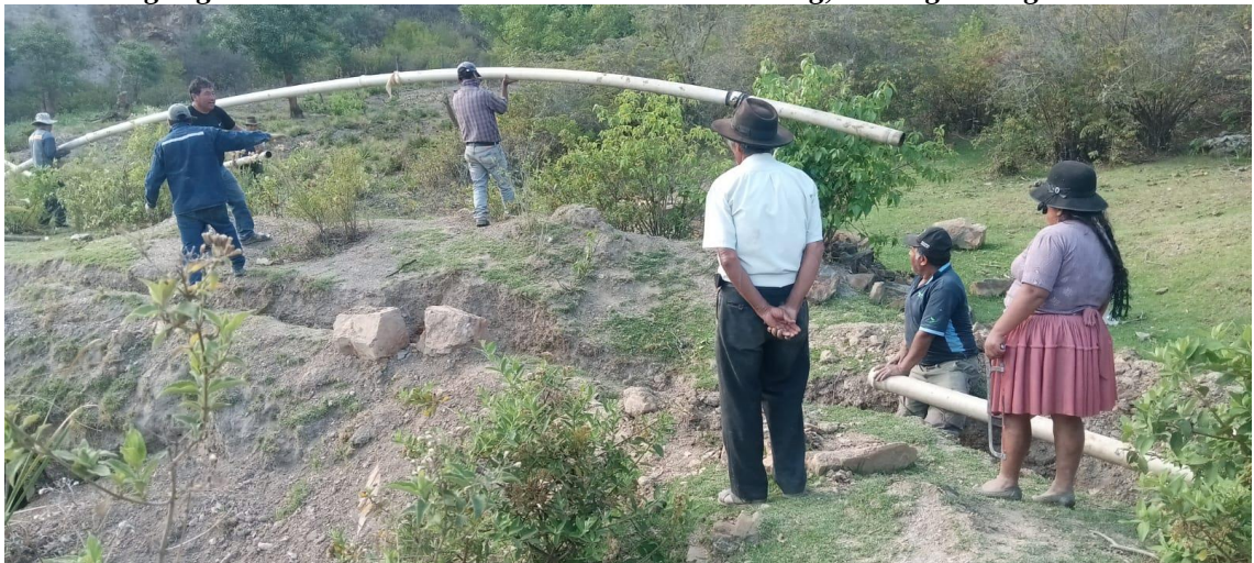
System zur Wasserzufuhr in die Mikrolagune, mit Polyubes in unterirdischen Kanälen.
