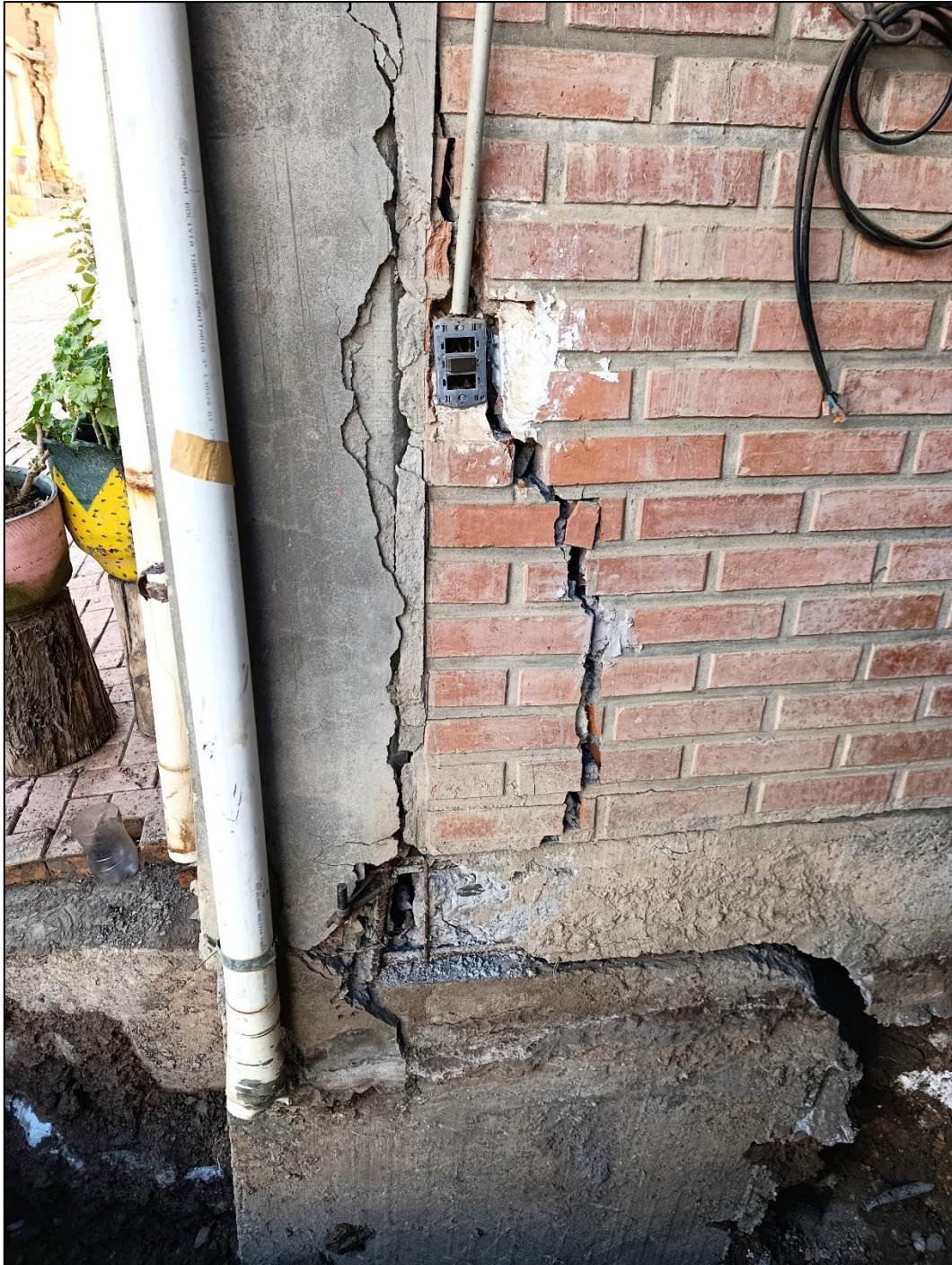
Abb. 4: Einrisse in der Außenwand
