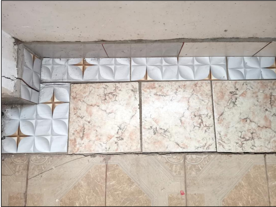
Abb. 2: Risse in den Fliesen, die ebenfalls erst kürzlich ausgetauscht wurden.
