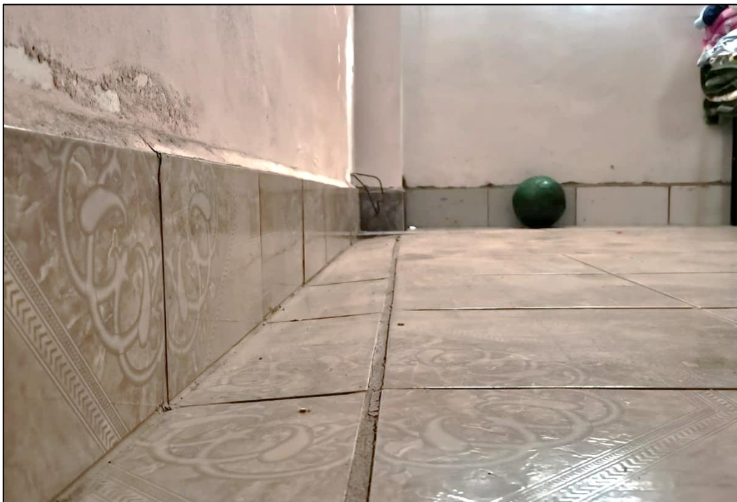
Abb. 3: Die Mauern auf der linken Seite des Bildes haben sich abgesetzt, sodass die Fliesen nun abschüssig ausgerichtet sind.
