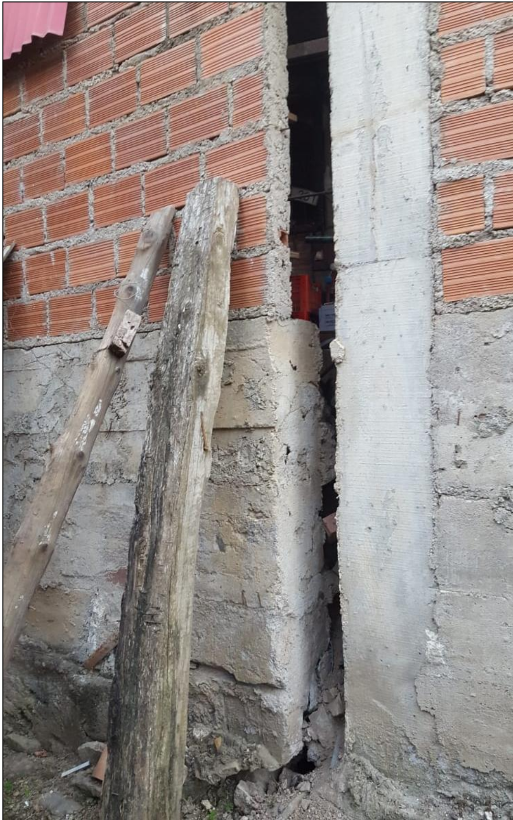
Abb. 5: Auseinandergerissene Mauer des Außenbereichs
