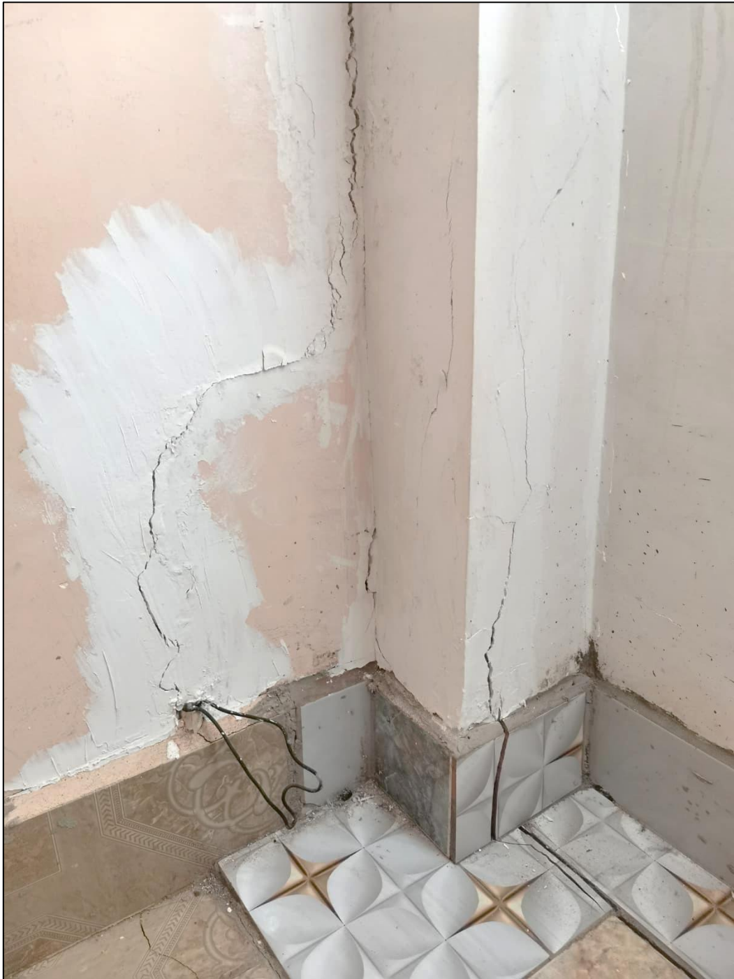
Abb. 1: Einrisse an den Innenwänden, die vor wenigen Wochen bereits einmal verschlossen wurden (weiße Farbe) und kürzlich erneut aufgerissen sind.
